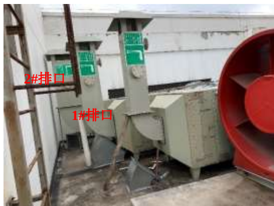
1#、2#废气排口及活性炭吸附装置
